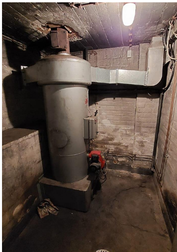
Lammin kappelin lämmitysjärjestelmä
